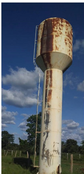
Figura 3- Caixa d'água instalada pelo INCRA
